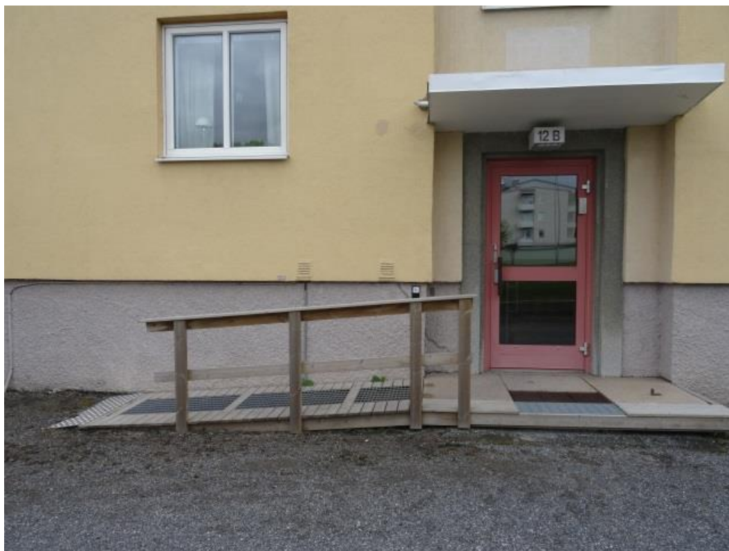
Exempel på ramp och vilplan till entré. Ledstången är dock för kort.
