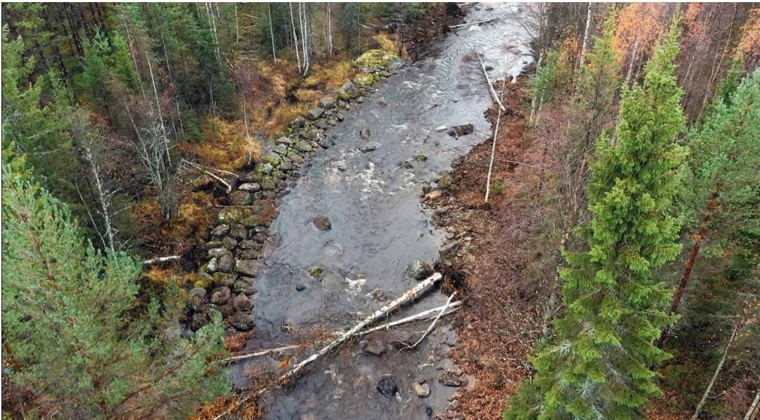
Figur 8: Område 2 i Svartån efter åtgärd där släntmur på vänstra sidan har lämnats orörd. Denna är släntmur var den best bevarade.
