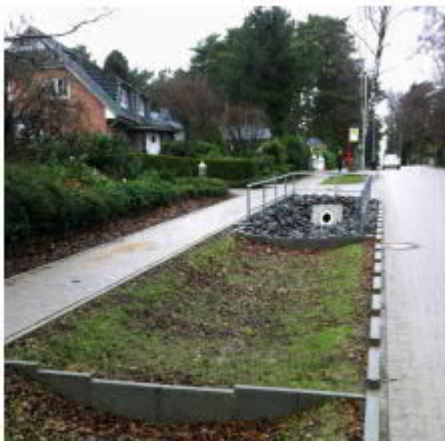
Figur 13. Svackdike med inloppsledning och dämnen (Stockholm Vatten och Avfall).
